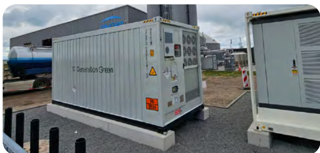
5 MWh Batterij van Sustenso bij de vergister van Engie
