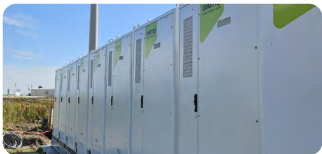
2 MWh Batterij bij Energiehub InVesta
